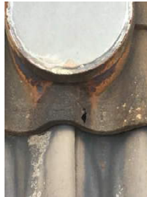
Tagvindue i loftrum hvor jernet er gennemtæret.
