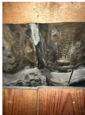
Tegl set indefra – her mangler en del af understrygningen i det lodrette overlæg, formentlig da understrygning her er svært tilgængelig for reovering.
