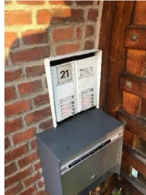
Dør tlf. anlæg
