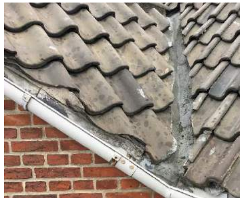
Skotrende ved karnap. Forskælling (mørtel) under de yderste tegl er gammel og porøs og flere steder faldet ud. Skotrende ses at være blevet smurt med tætningsmasse udefra. Her opleves fugt i lejligheden nedenfor, men det er umuligt at se udefra hvor fugten kan komme ind.
