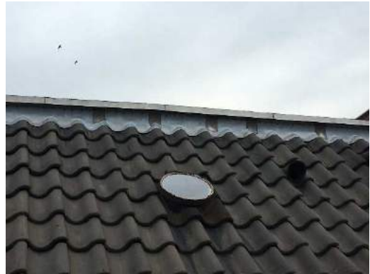
Inddækning ved tagovergang fremstår med mange lapper.
