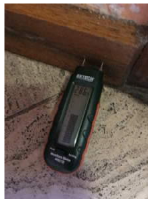
Fugtmåling i fodpanel indenfor hoveddør viser 28,6% træfugt, hvilket er højt og tyder på at væggen er opfugtet.
