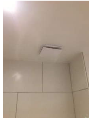
Udluftningsventil i badeværelse
