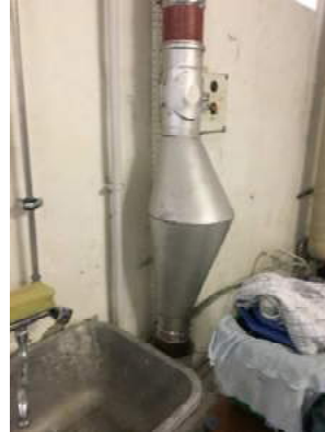
Renselem og rottespærre på faldstamme i kælder
