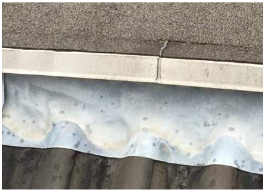
Tagpap ved tagovergang fremstår med revne.
