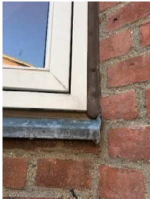
Vinduesfuge ved bundkarm - fuger fremstår med fin vedhæftning.
