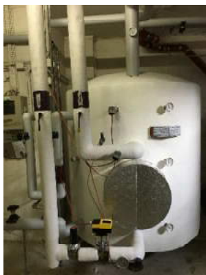
Ny varmtvandsbeholder i varmecentral.
