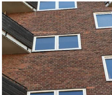
På facade ses at være udskiftet enkelte teglsten.
