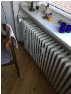
Ældre støbejernsradiator i lejlighed
