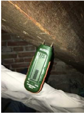
Fugtmåling i kel-spær under skotrende viser 22% træfugt. Ved træfugt over 20% er der risiko for råd- og svampeskader.
