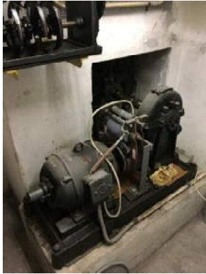
Maskinrum (spilrum) i kælder
