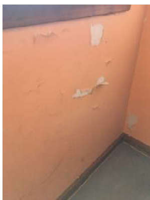
Afskallende maling på vinduesbrystning i trappeopgang.
