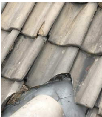
Ødelagt tegl over skotrende ved karnap.
