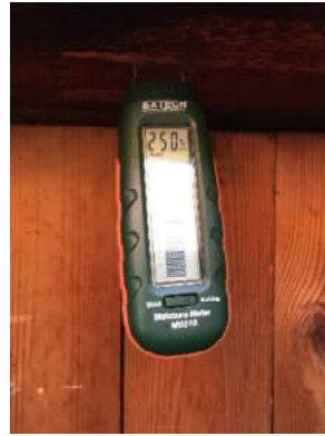
Fugtmåling i træunderlag omkring ovenlyskuppel i det flade tag viser 25% træfugt.
