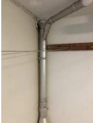
Nyere faldstamme i rustfri stål i kælder
