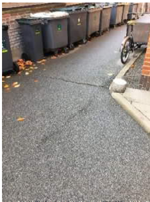
Asfalt med revne
